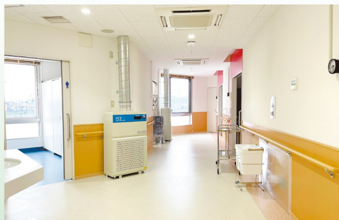
廊下の陰圧装置
